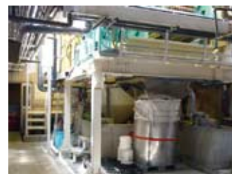
酸・アルカリ廃液社内処理設備
